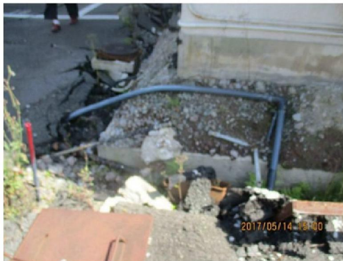
「Jマンション」 昭和54年築 15戸 S造3階建て 震災前から居住者がいなかったようで、荒れ放題の マンションでした。
